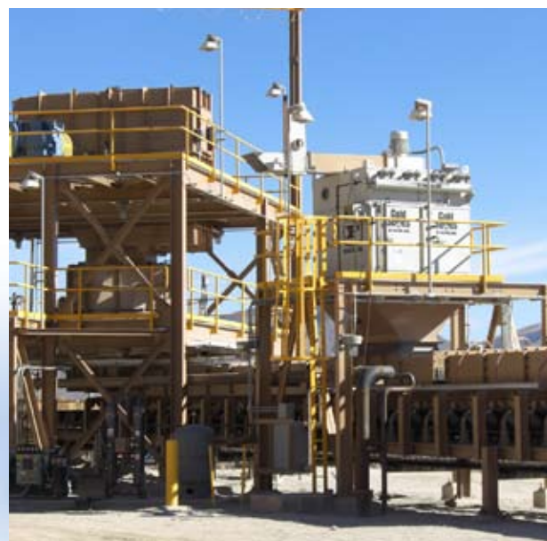
Un GS en un punto de transferencia de transportador-a-transportador
