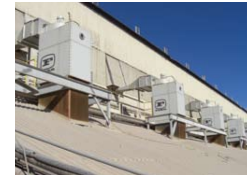
Ventilador del contenedor de almacenaje de mineral sin refinar
